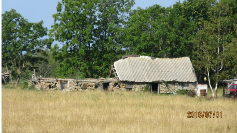
Erkas ladugård efter tromben, halva yttertakets har blåst av
